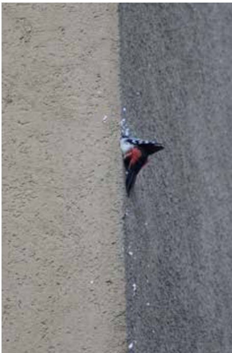
Durch Spechtlöcher dringt Feuchtigkeit ein und sie reduzieren die Dämmwirkung der Isolation. Die Löcher sollten deshalb möglichst bald verschlossen werden. Reparaturen sind aber tabu, solange Vögel darin Junge aufziehen. Ihre Bruten sind gesetzlich geschützt!
