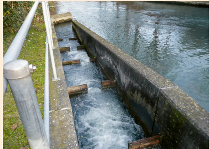
Sanierungsbedürftige Fischaufstiegshilfe beim KW Blatten.
