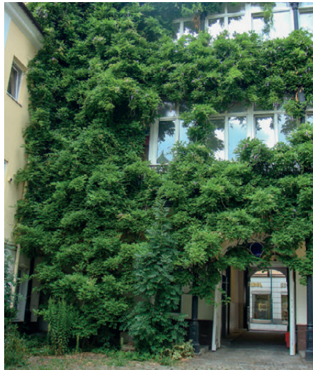
Alte Kletterpflanzen können schwer werden und benötigen oft eine zusätzliche Absturzsicherung.
