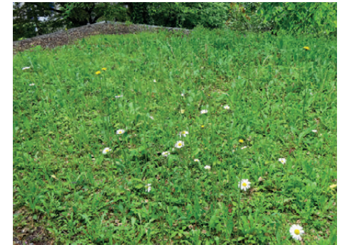
An schattigen Stellen wächst auch auf einem extensiv begrünten Dach eine lockere Wiese.
